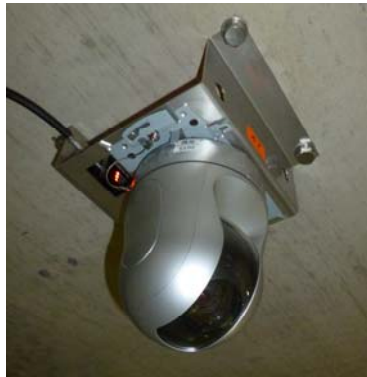
本体室上部に 設置されたITV
