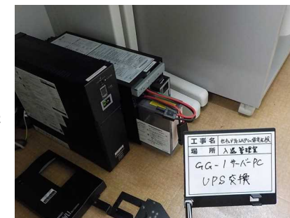
入退管理サーバ用 UPSバッテリー交換 の様子
