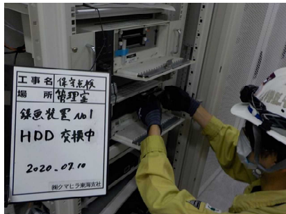
ITVレコーダー HDD交換の様子
