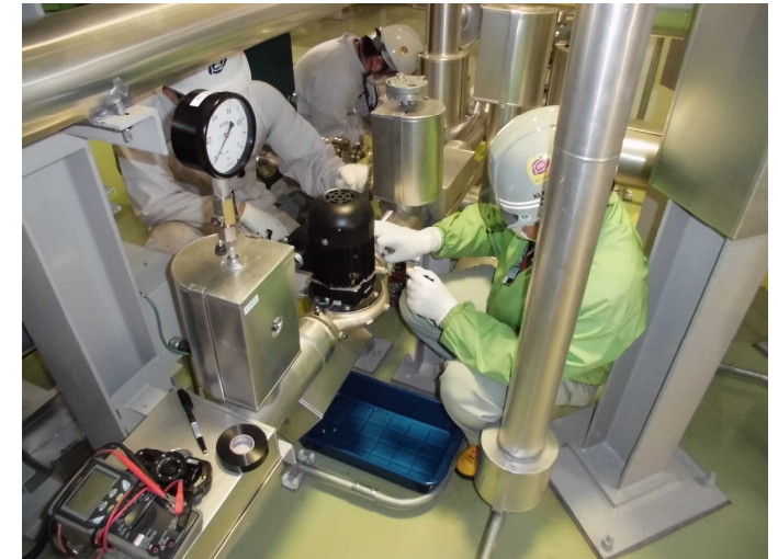
冷却水循環ポンプ保守点検の様子
