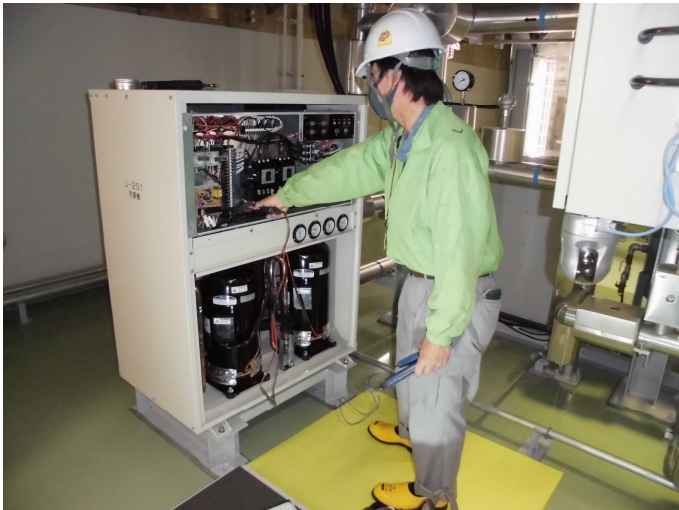
冷凍機保守点検の様子
