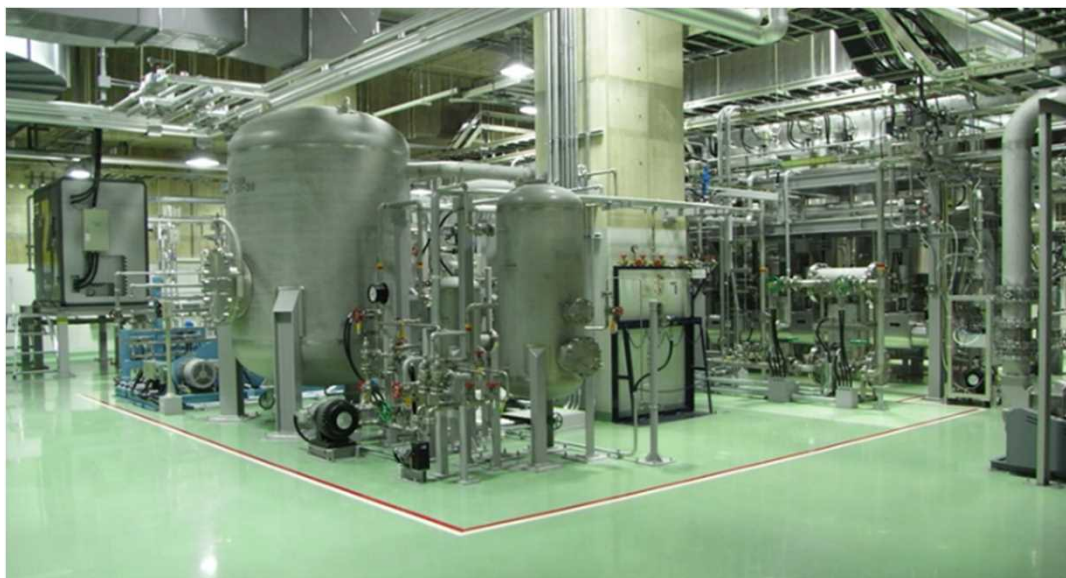
排気ガス処理システム
