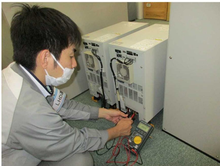
無停電電源装置 電圧測定の様子
