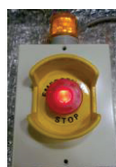
写真2 非常停止 ボタン
